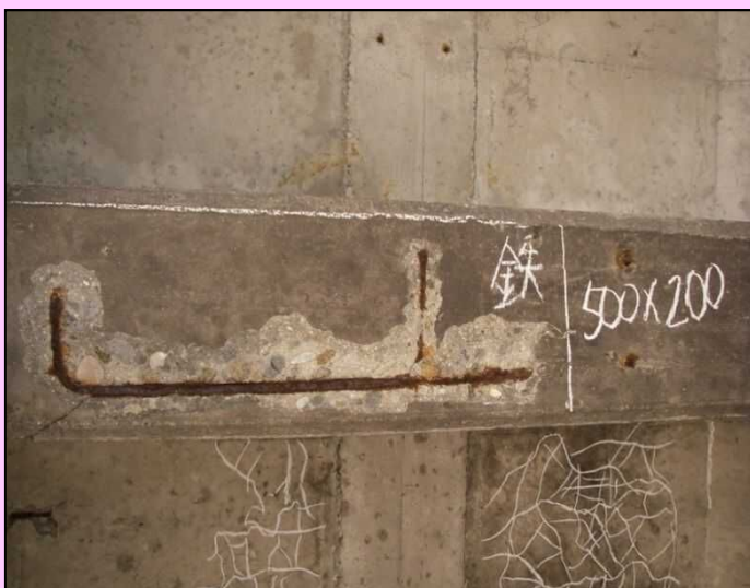
鉄筋露出状況（山香院内線：境橋）
