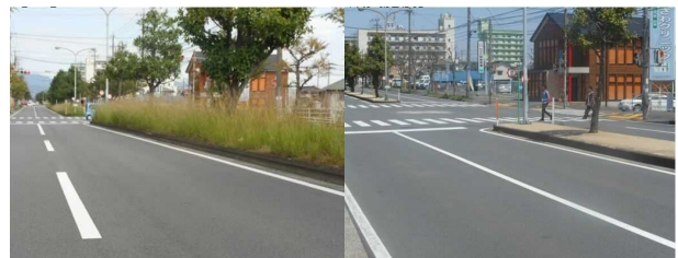
中央分離帯の防草対策
