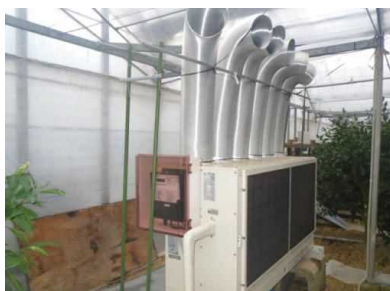
ハウスみかんで進むヒートポンプの導入
